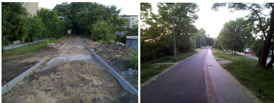
Fot. 9-10. Prace nad powstaniem pierwszego odcinka „Zielonej Strzały” w okolicach ul. Krośnieńskiej, 2008 vs. 2011
